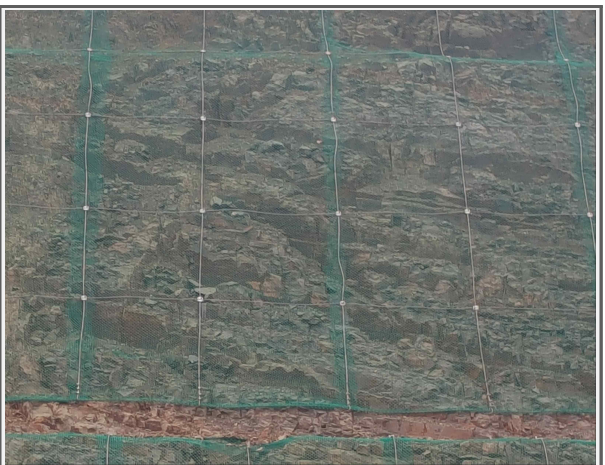
④ Sta.3+405부근(상주) 2소단 상부 고각절리 발달
